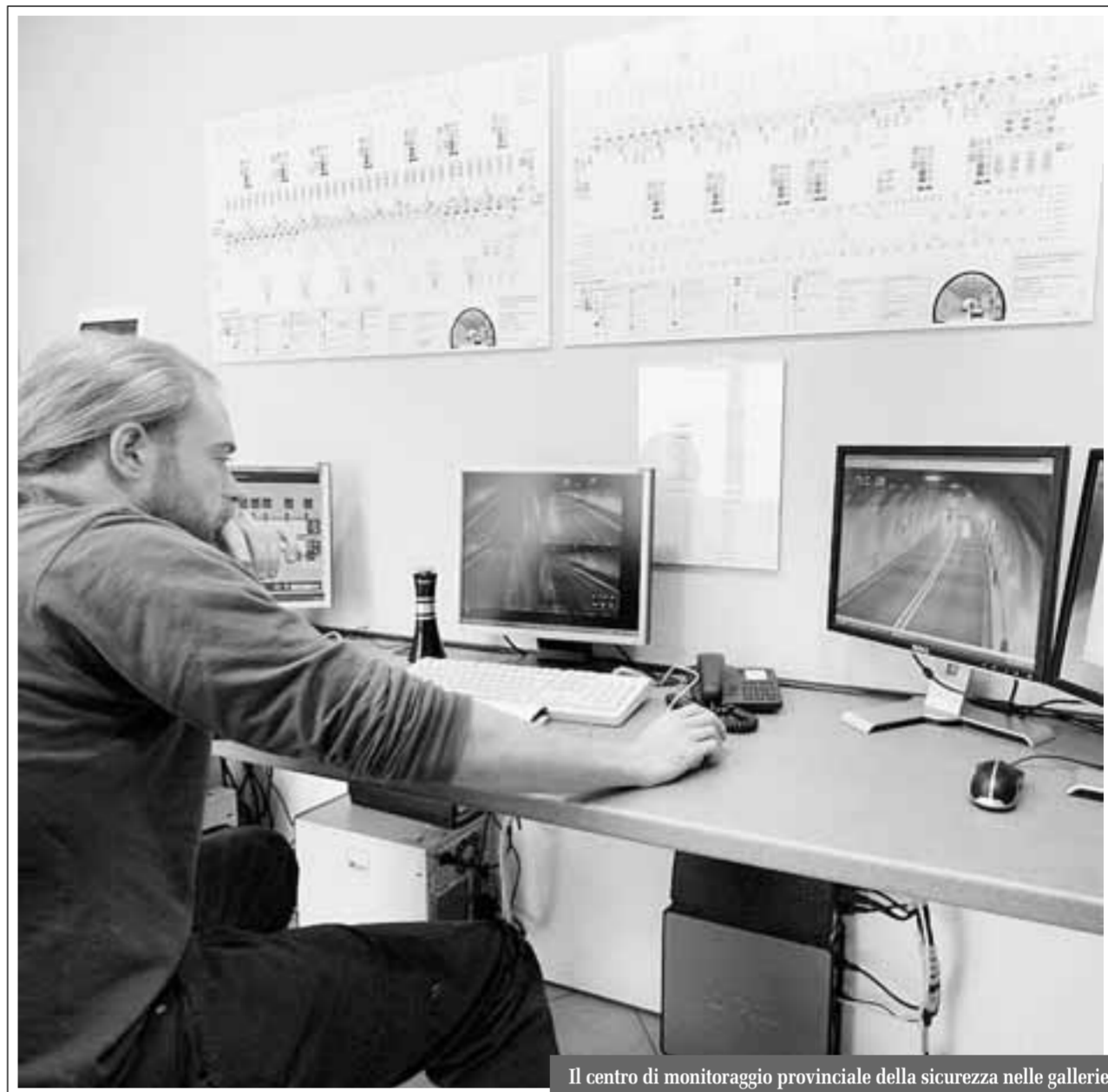
Il centro di monitoraggio provinciale della sicurezza nelle gallerie
